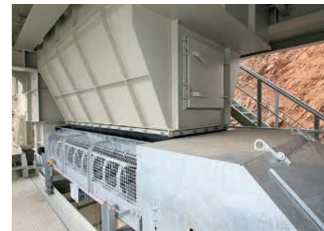
Wartungsfreundlicher Trichter über einem Gurtförderer
