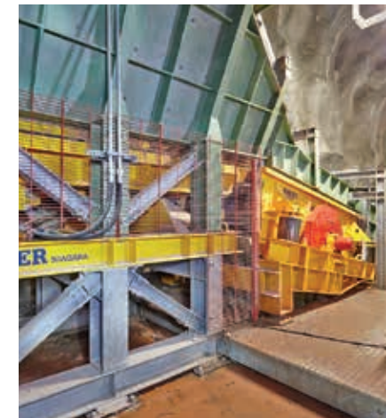
Vorbrechanlage, Fluss- und Feldspat, 80t/h, HAVER F-CLASS, HAVER Schubwagen, Backenbrecher
