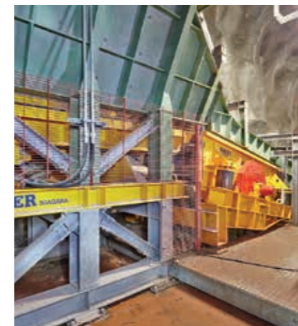
Vorbrechanlage, Fluss- und Feldspart, 80t/h, HAVER F-CLASS, HAVER Schubwagen, Backenbrecher
